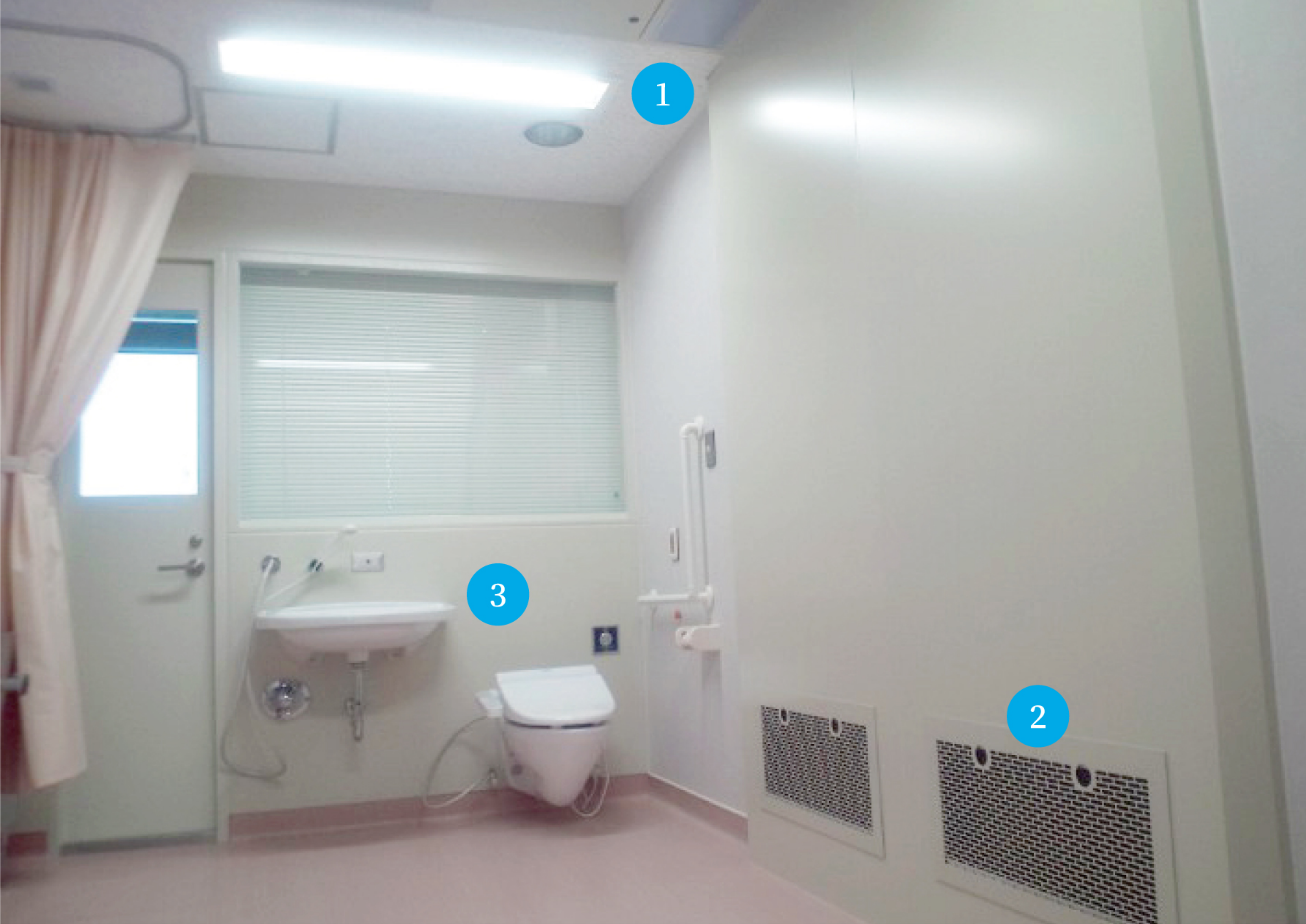
垂直層流型無菌病室ユニット（1床タイプ）内部
